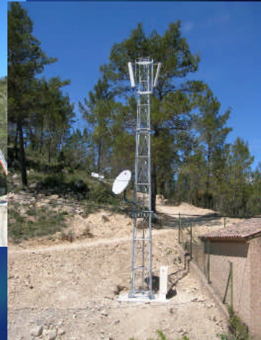
Pylône terminé, herse, parabole
