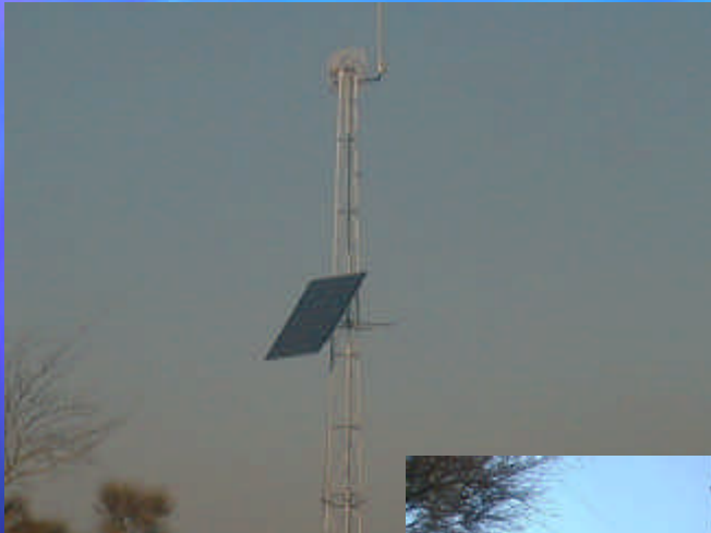
Site de Montestruc (Gers) Alimentation Pylone 250 W Solaire + FH + WIFI
