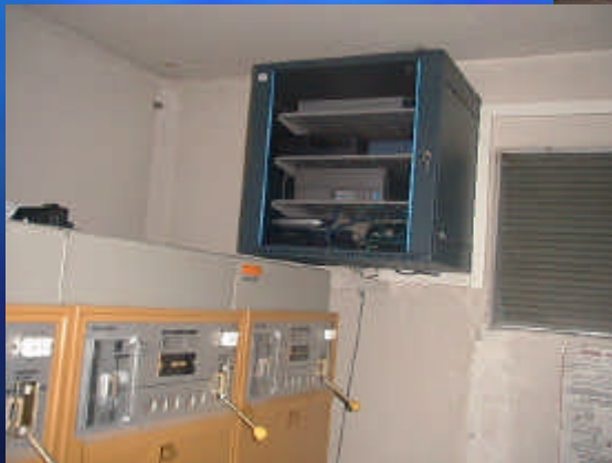
Poste « Eglise » Autrans (Isère)
