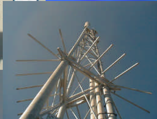
Pylone du Pic de Vinas construit par INFOSAT (supportant plusieurs FH et Routeurs embarqués)
